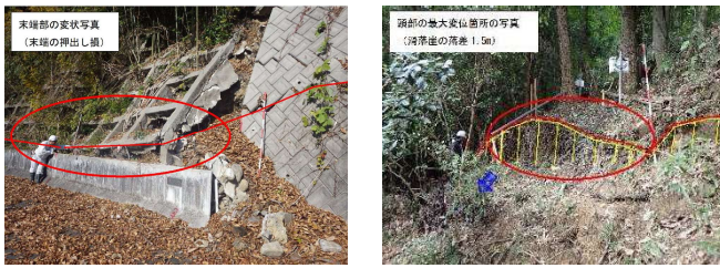
写真-5 被災法面断面状況
