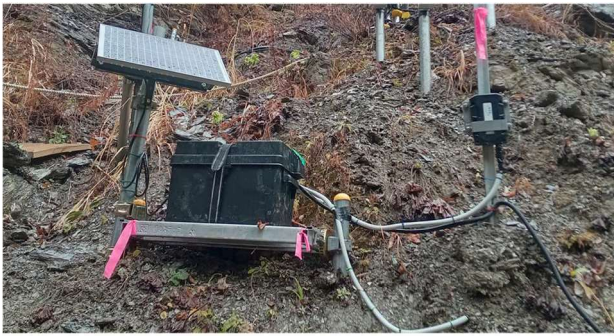
写真-3 計測システム設置状況
