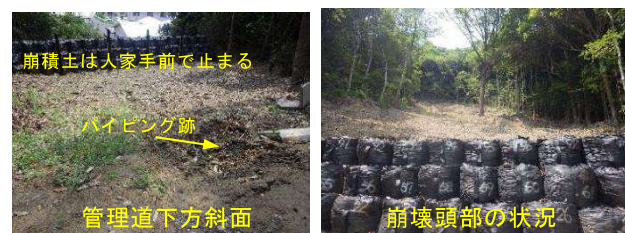
写真-1 東側崩壊斜面の状況
