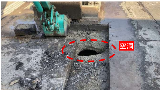
図-1 路面直下に出現した空洞の例
